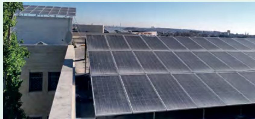
Solaranlage auf der Dar Al Kalima Schule
